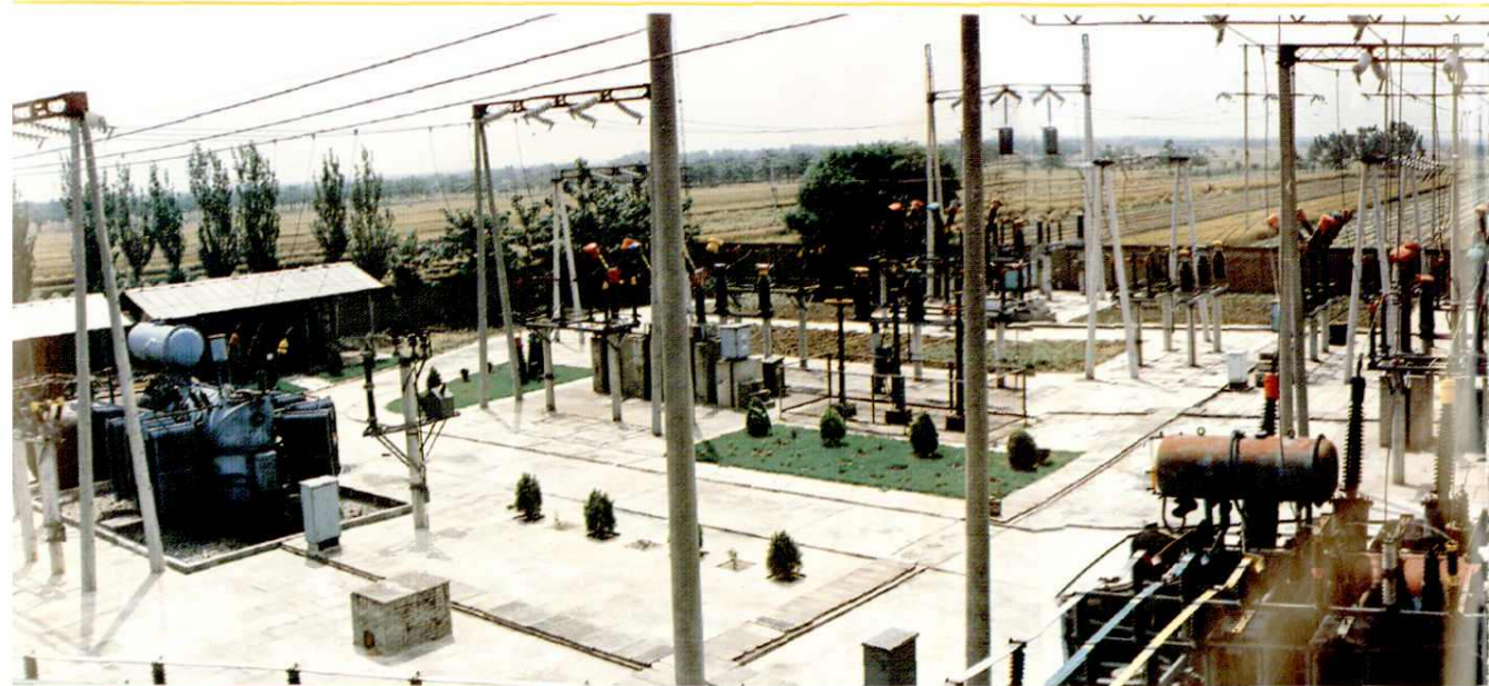
王村 110 千伏变电站
