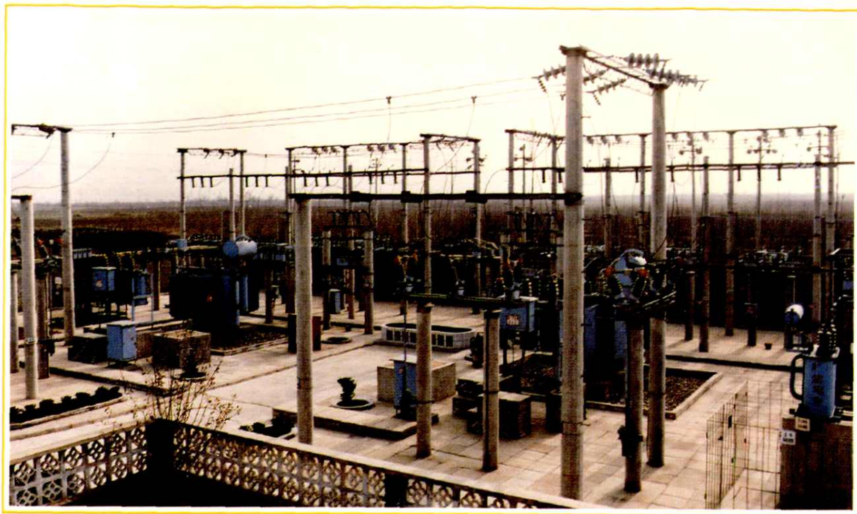
北辛 35 千伏变电站
