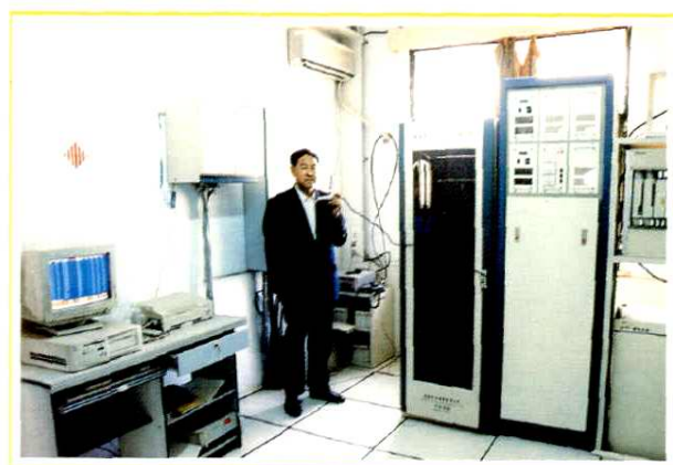
电网通信自动化
