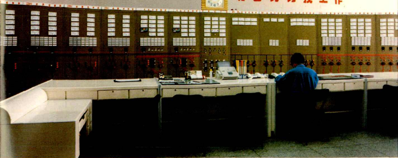
临晋 220 千伏变电站主控室
