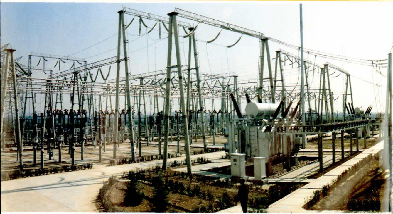
临晋 220 千伏变电站全貌
