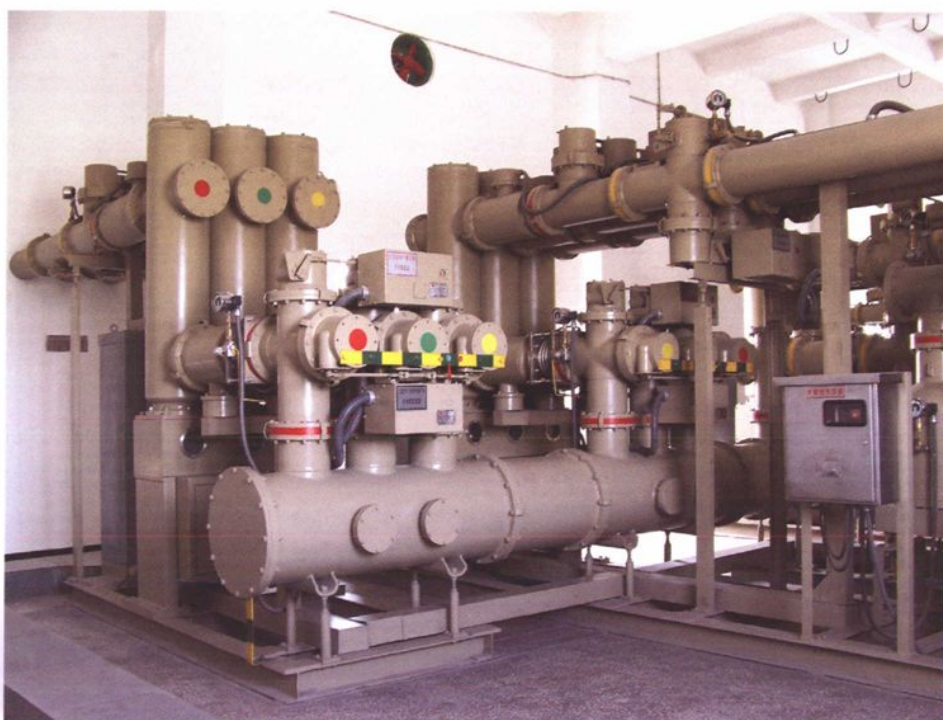
110 千伏铁西变电所六氟化硫全封闭组合电器
