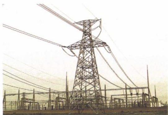
220 千伏克拉玛依变电所
