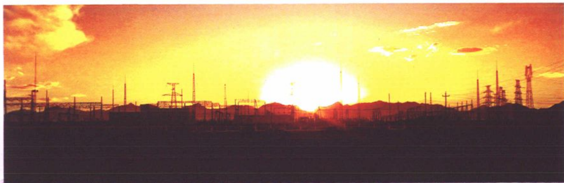
220 千伏龟兹变电所
