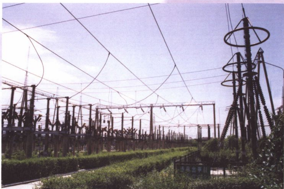
220 千伏米泉变电所
