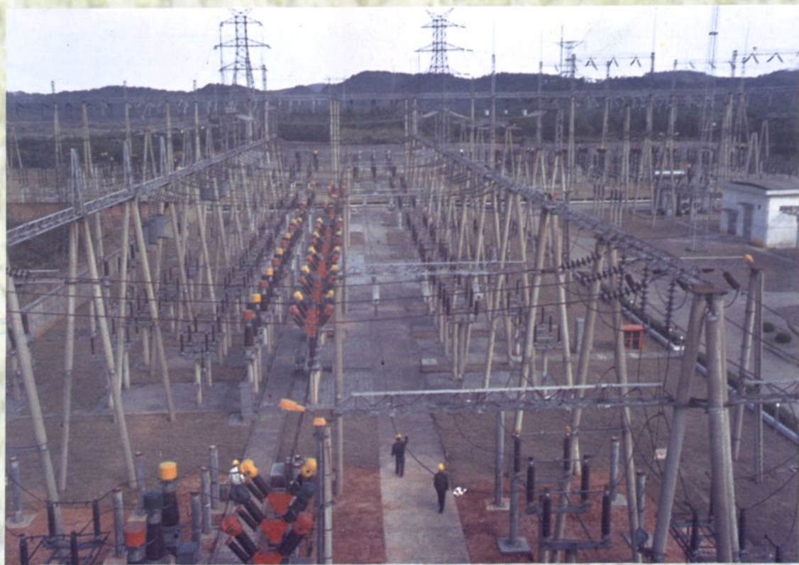
变电站值班人员认真仔细地巡视设备
