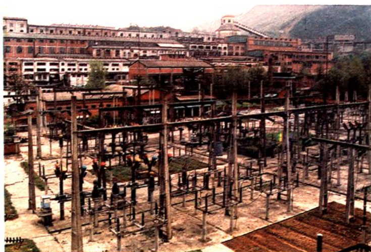
第一座 110 千伏泗洲庙变电站
