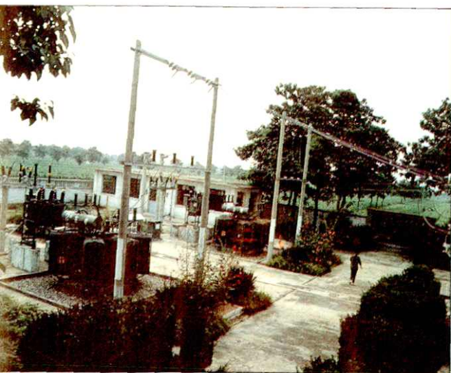
临猗县郭村 35 千伏变电站。
