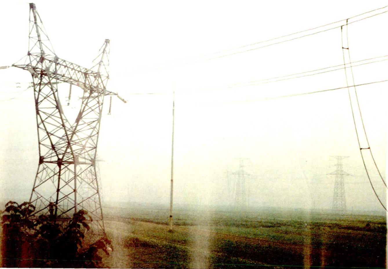
220 千伏输电线路。
