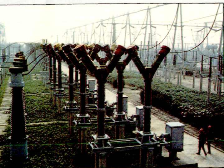
新绛 220 千伏变电站。
