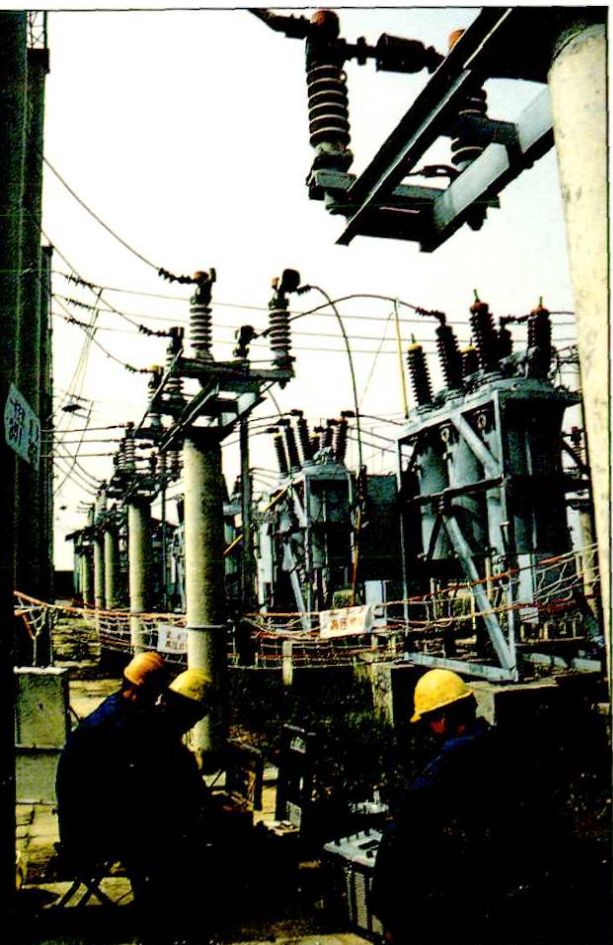
变电工区修试人员在新绛变电站进行测试
