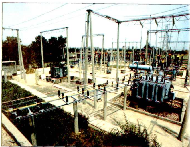
东镇 110 千伏变电站。
