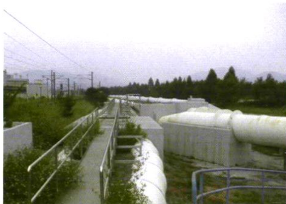
香港境内东深供水工程的输水管
