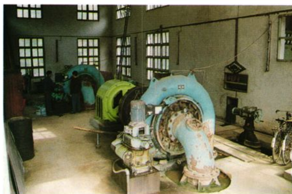
▲ 霞沙洲电站机房一角
