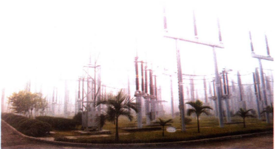
玉皇观 22 万千伏变电站
