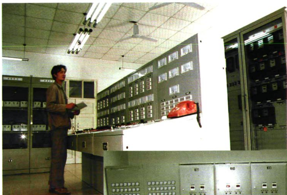
◀ 新建投入运行的磷酸浓缩装置高压电配电室
