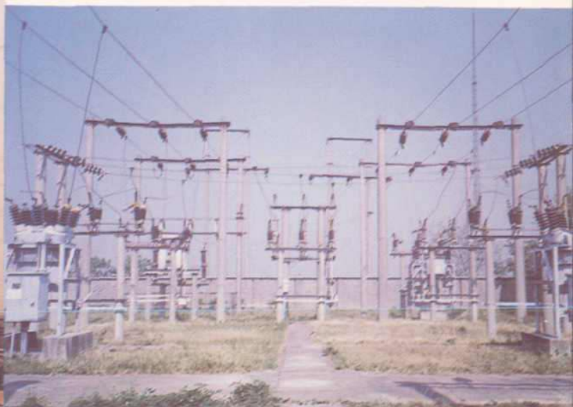
▼ 拔茅山 35 千伏变电所
