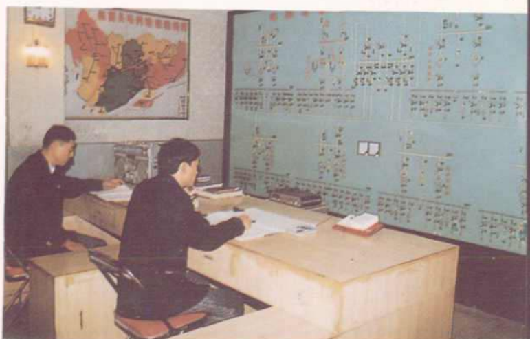
▲县局电力调度室
