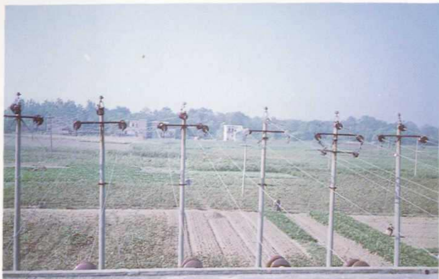
▲ 汤沟 35 千伏变电所
