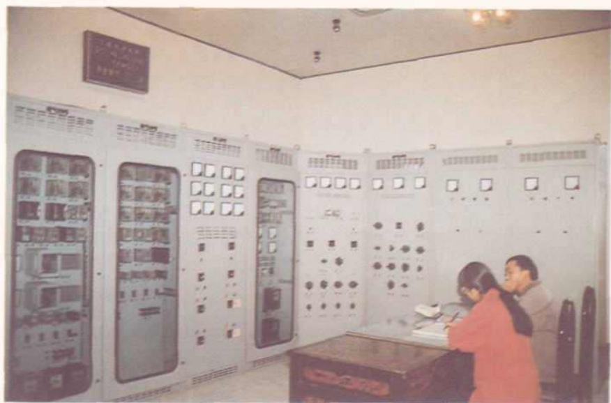
▲ 下枞阳 35 千伏变电所
