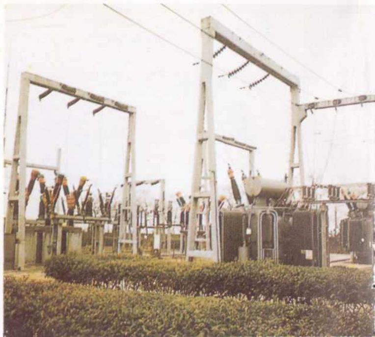
▲横埠 110 千伏变电所
