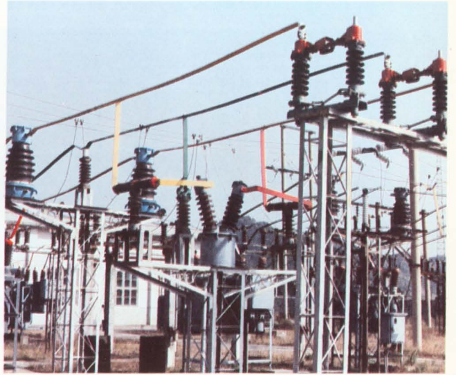
▲ 富阳中心变电站
