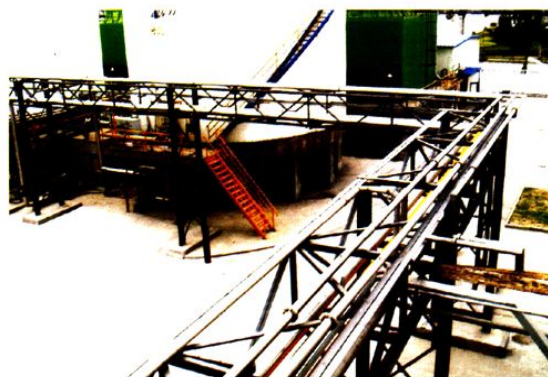
院研制生产的低温输液管道在钢厂使用现场
