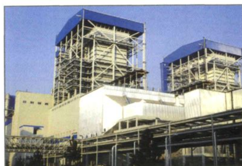
山西柳林华光电厂一期工程
