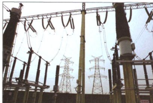
太原向阳变电站工程
