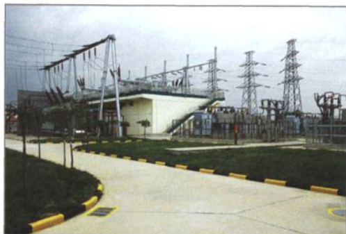
大堡头变电站工程
