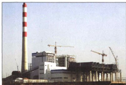
山西瑞光电厂工程
