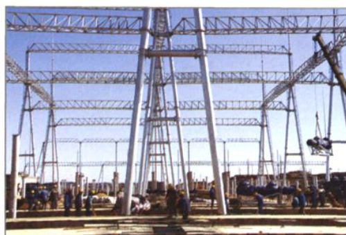
阳城北变电站工程
