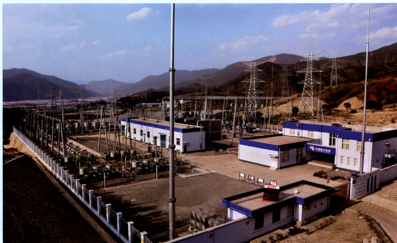
2013年10月31日建成投运的220千伏峨山变电站，站址位于玉元高速公路化念收费站出口
