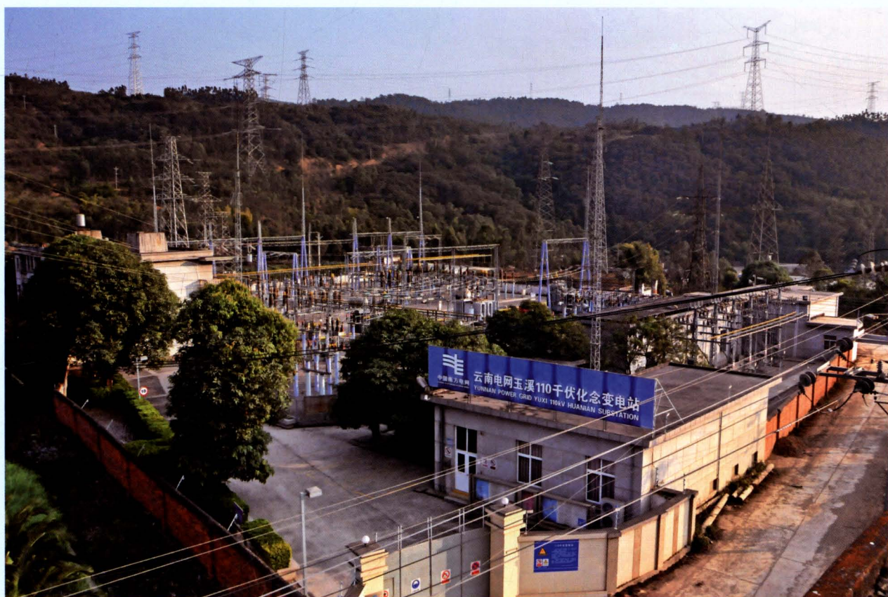
1977年2月16日建成投产的110千伏化念变电站，站址位于峨山县化念镇下班秧村
