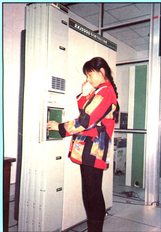
横塘邮电所程控机房
