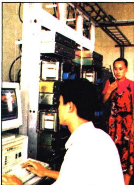
省内县(市)级首开的 800 兆集群电话机房
