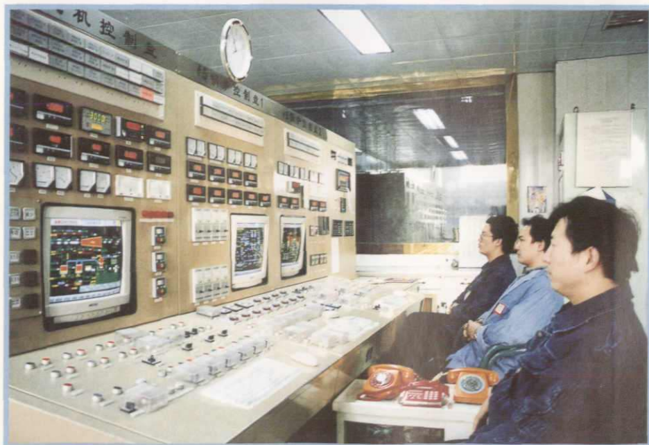
5号机炉控制室
