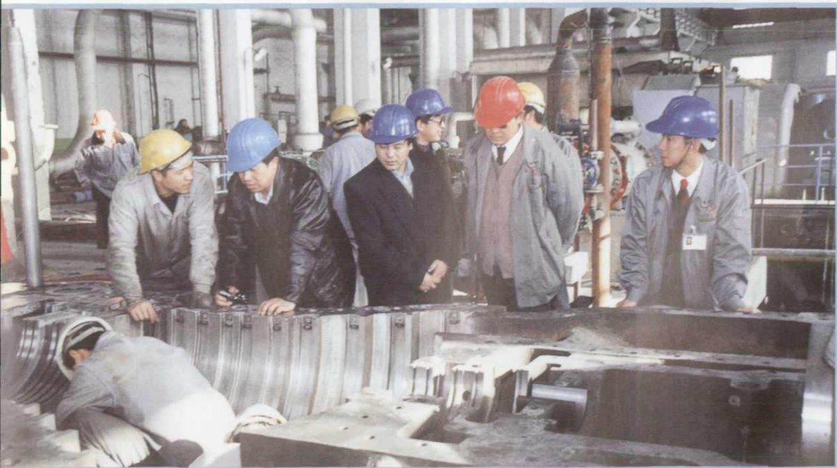
厂领导王征（左二）、季风印（左三）、李允行（右二）、吕天福（右一）检查5号汽轮机安装进度
