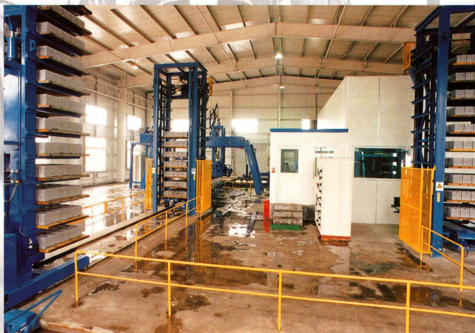
华能济宁电厂与意大利罗沙科美达公司合资兴建的新型建材厂生产线
