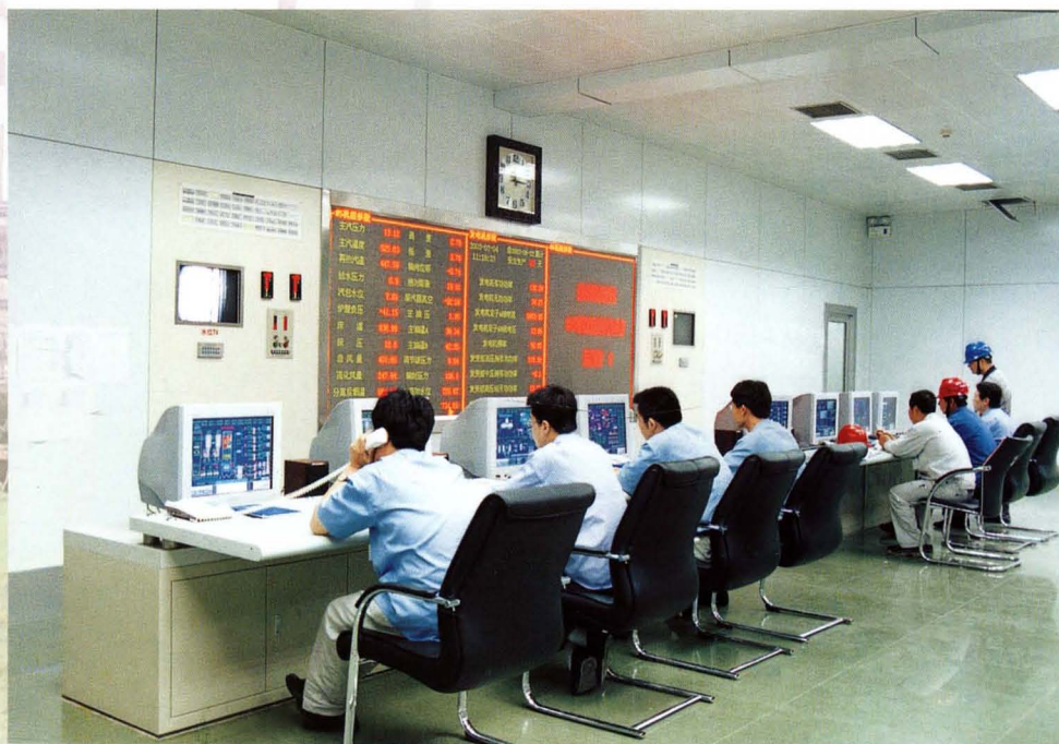
新扩建的五号、六号机组集控室
