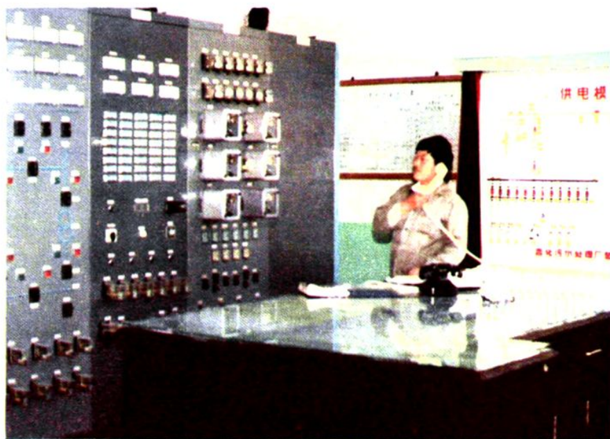
总降变电所控制室
