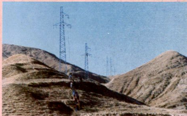
35 千伏阳堡线铁塔
