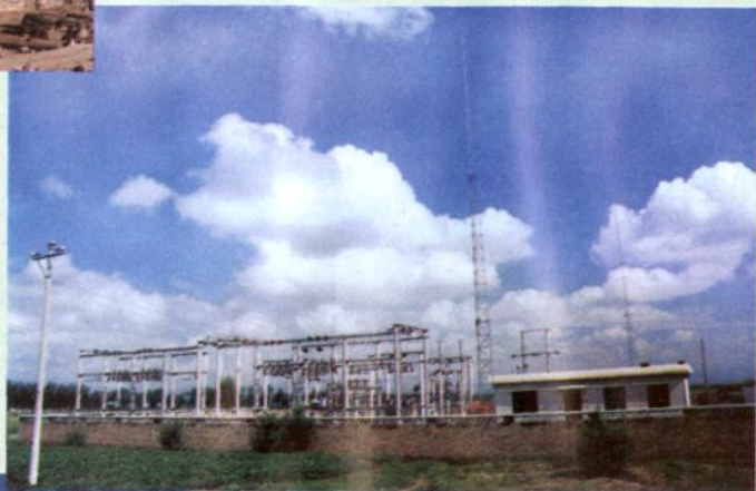
古城 35 千伏变电站
