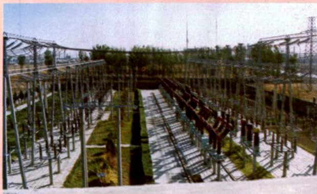
阳高 220 千伏变电站架构区
