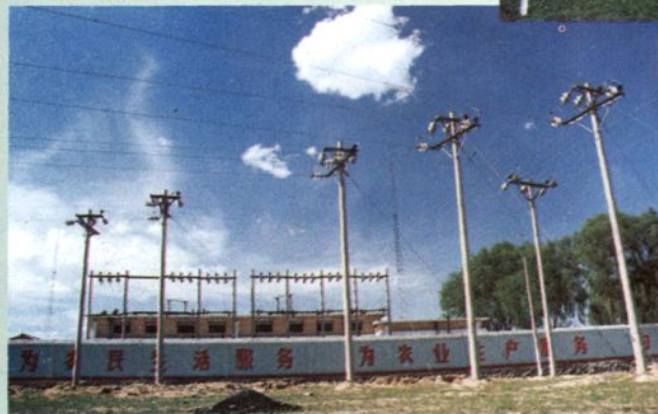
罗文皂 35 千伏变电站
