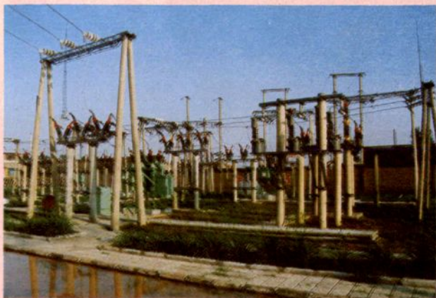
城关 110 千伏变电站架构区
