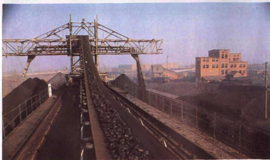
煤码头高架皮带
