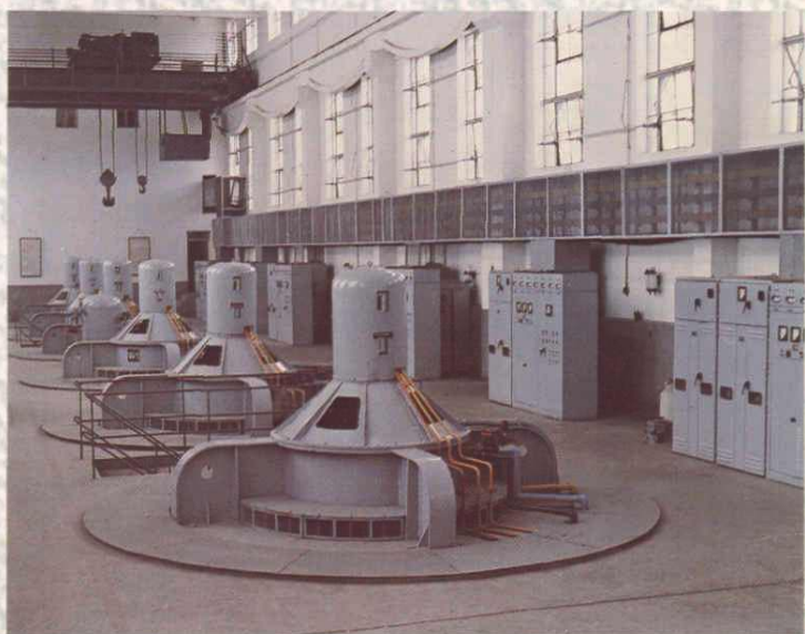
乌江抽水站机房
