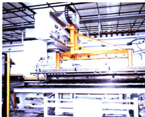
沈阳宝钢钢材配送有限 公司激光拼焊生产线
