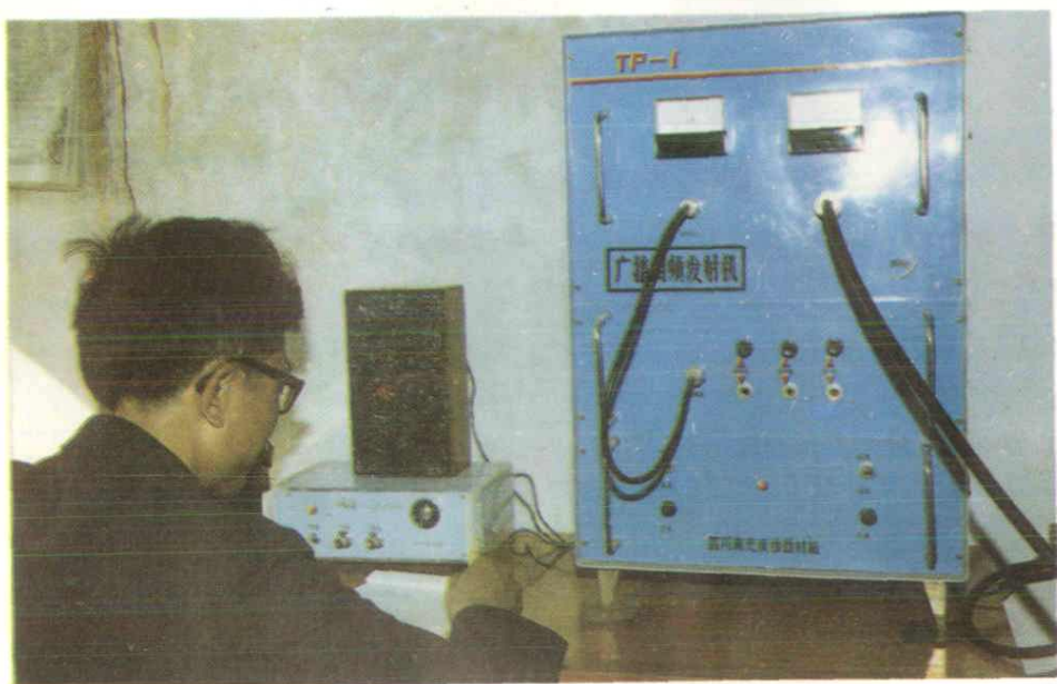
◀ 米易县调频广播机房。
