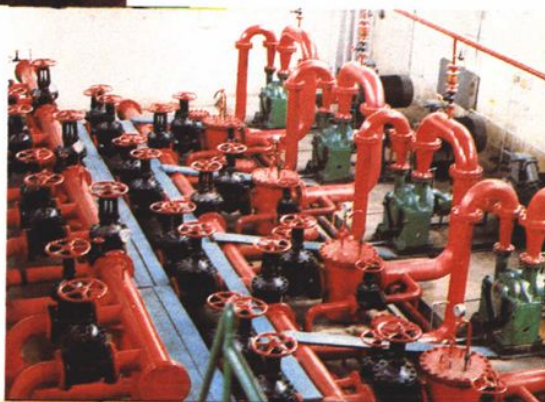
新城子区公司油库泵房
