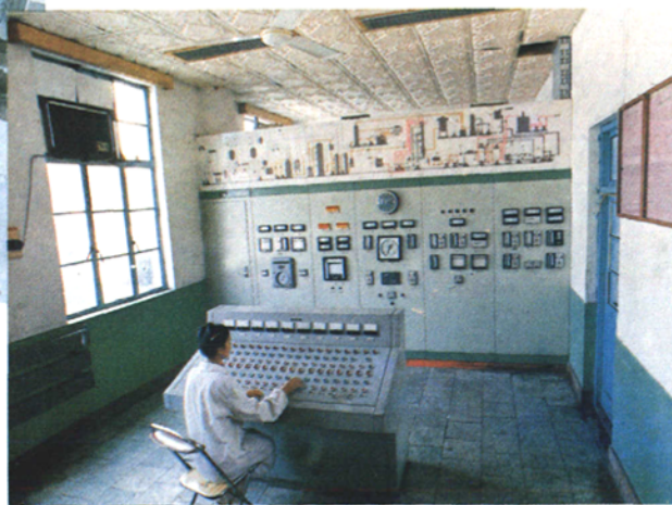
磺化车间控制室
