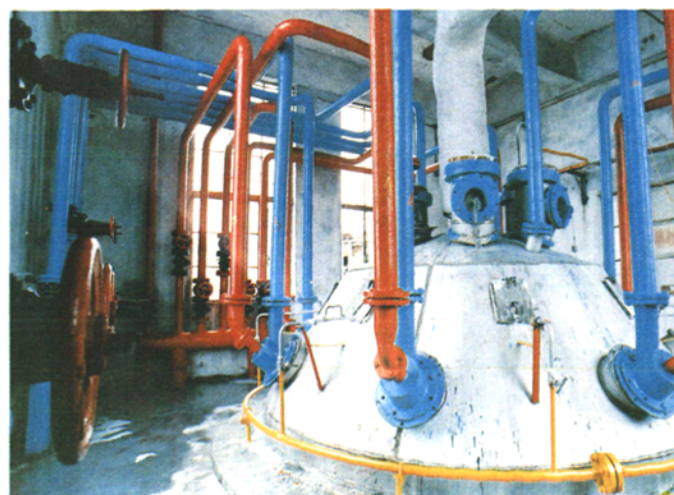
三聚磷酸钠喷粉塔塔顶
