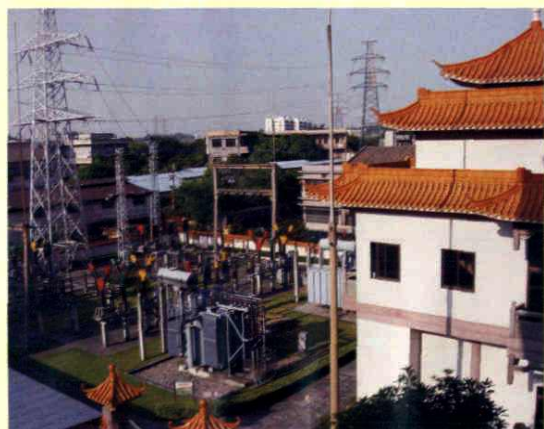
110千伏水南变站（1990年建成）
