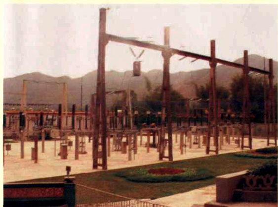
110千伏洪滘变电站（1989年建成）
