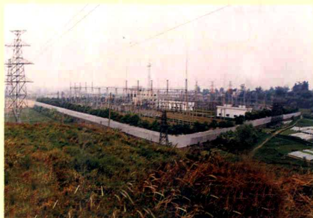
220千伏鹤山变电站（1994年建成）
