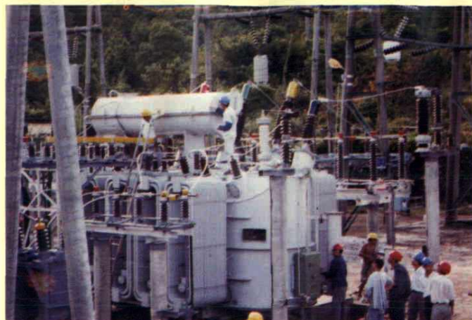
110千伏斗山变电站主变 扩建投运前检查（1999年）
