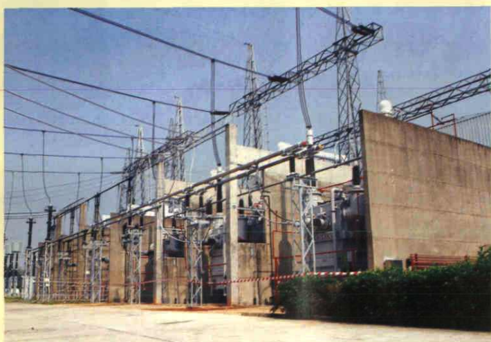
江门变电站500千伏主变
