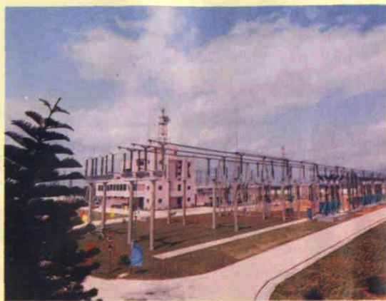
220千伏三江变电站（1995年建成）
