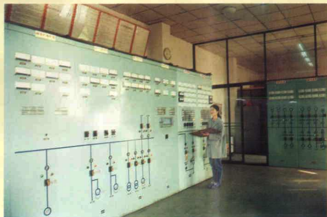
江门北街（联营）电厂控制室
