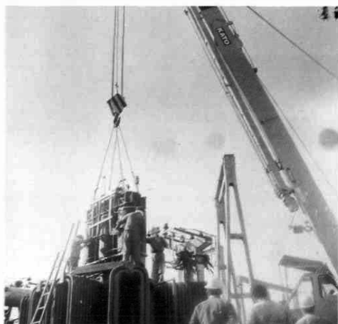
110千伏北街变电站 主变安装（1961年）
