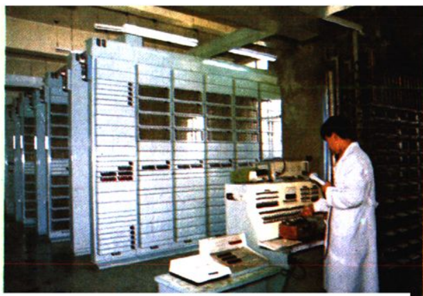
由电务大修段安装的通信自动交换机
