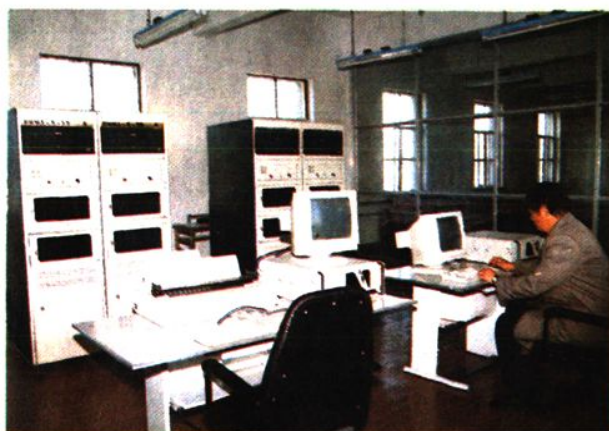
由电务大修段施工的苏北上行信号微机集中设备
