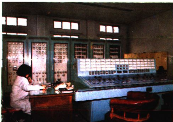
由电务大修段安装的北站电力配电所控制设备
