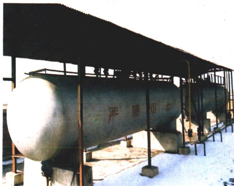
△電務大修段液化氣站
