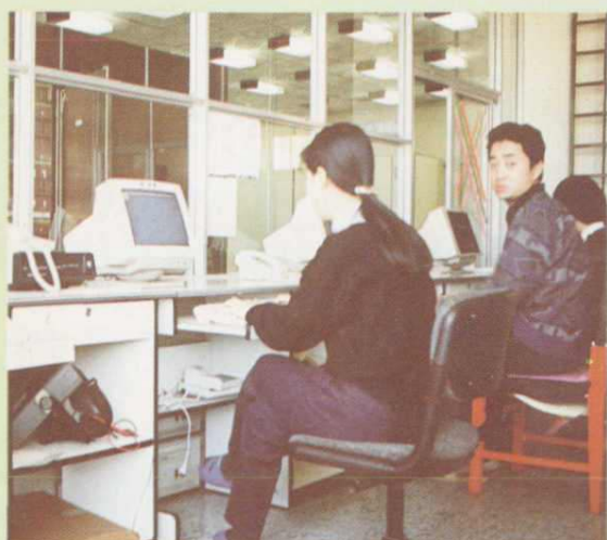
程控电话微机控制室
