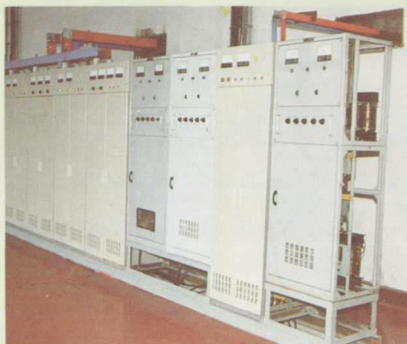
动力配电设备
