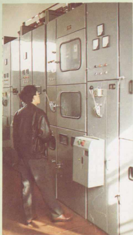
高压变电设备
