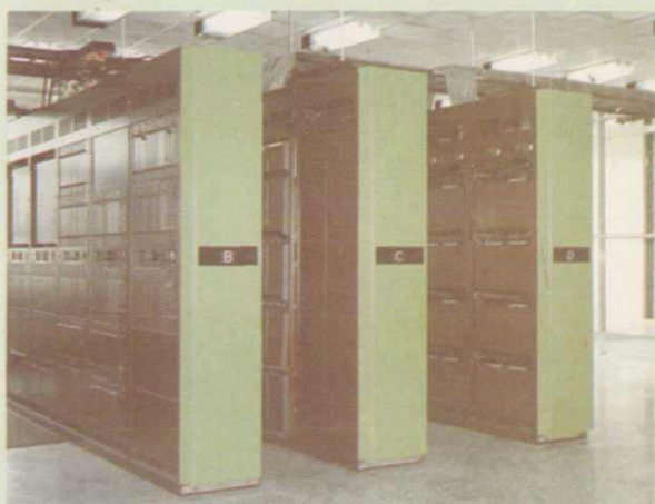
程控电话交换设备
