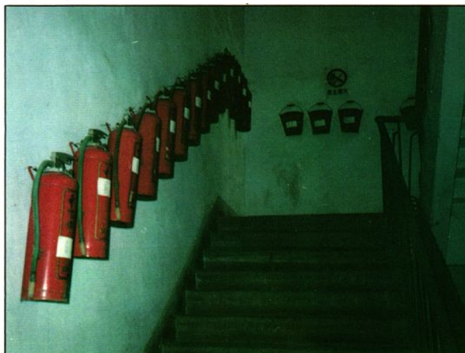
▶ 内江烟草分公司卷烟仓库消防设施
