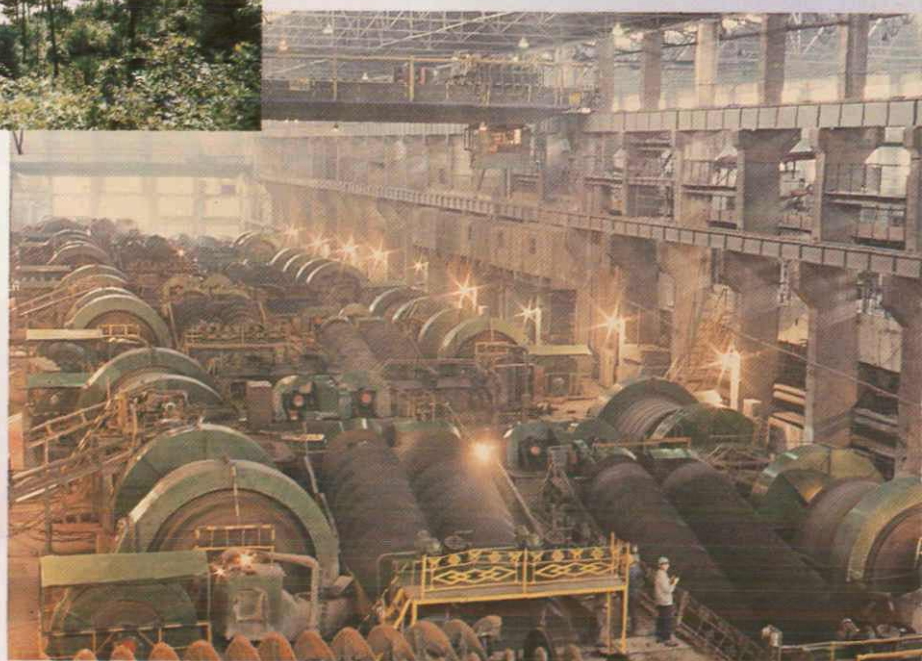
选矿厂主厂房内景
