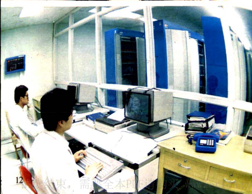
15、程控电话交换机房。
