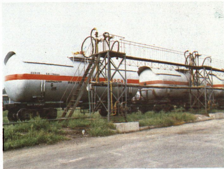
► 液化气火车槽车卸车线
