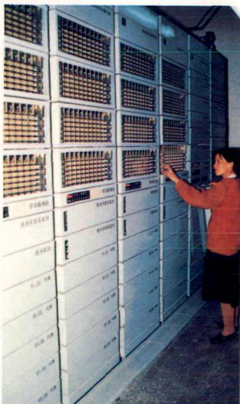
⇒ 县邮电局 2000 门程控电话机房
