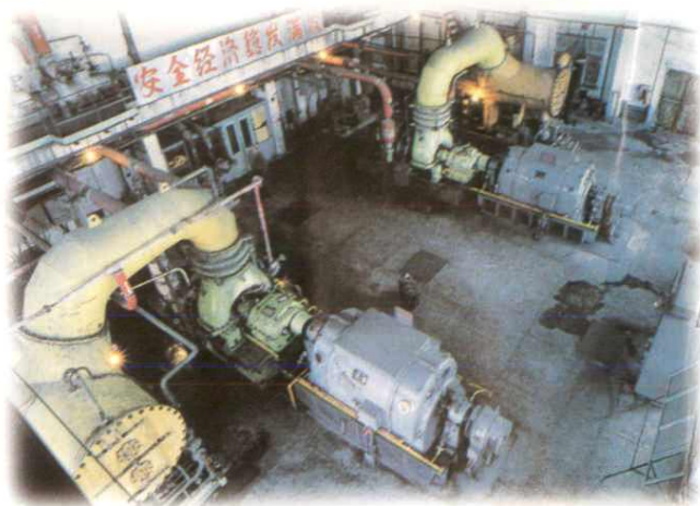
↑ 县火电厂发电机组
