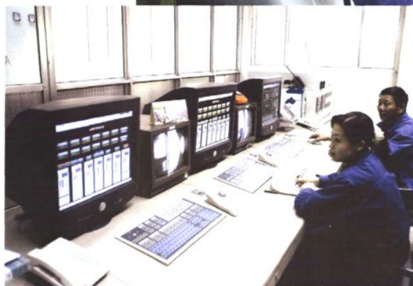
三车间电站实行微机化监控操作
