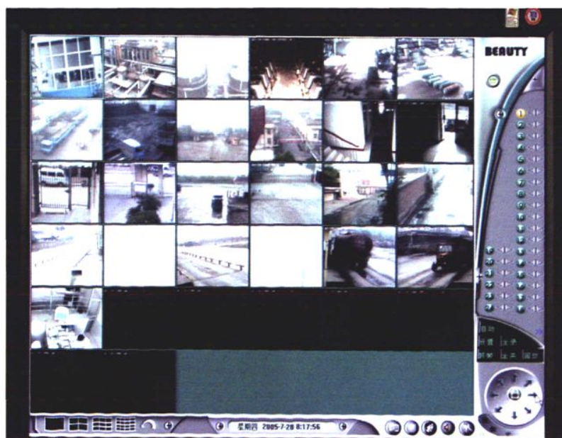
公司工业监控录像系统
