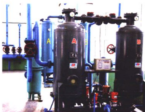
三车间空压机生产设备现场
