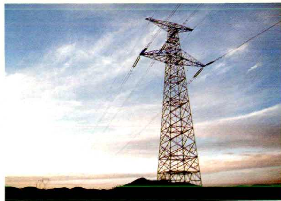
330 千伏秦岭电厂—西安北郊—咸阳庄头线路
