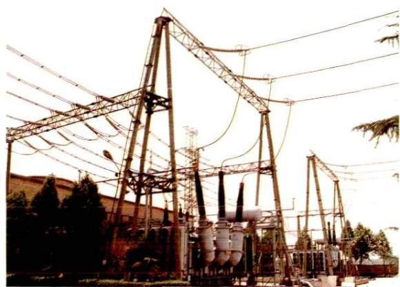
330 千伏庄头变电站一、二号主变
