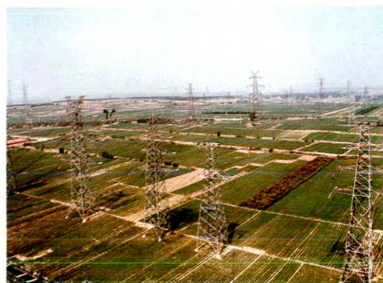
330 千伏西安南郊变电站 110 千伏出线塔
