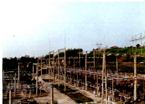
110 千伏安康江北变电站
