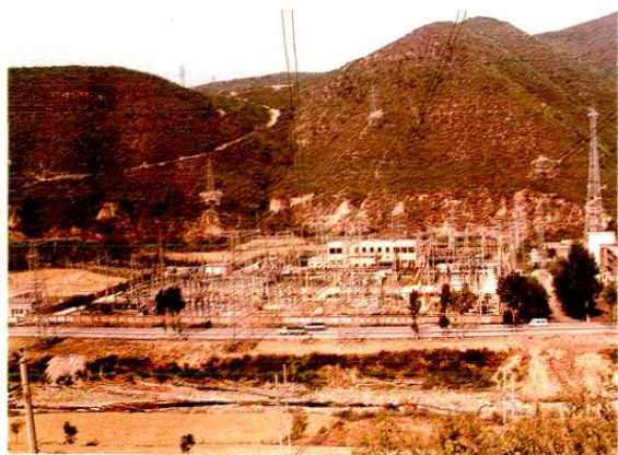
330 千伏金锁关变电站
