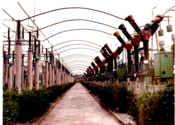
220 千伏勉县变电站
