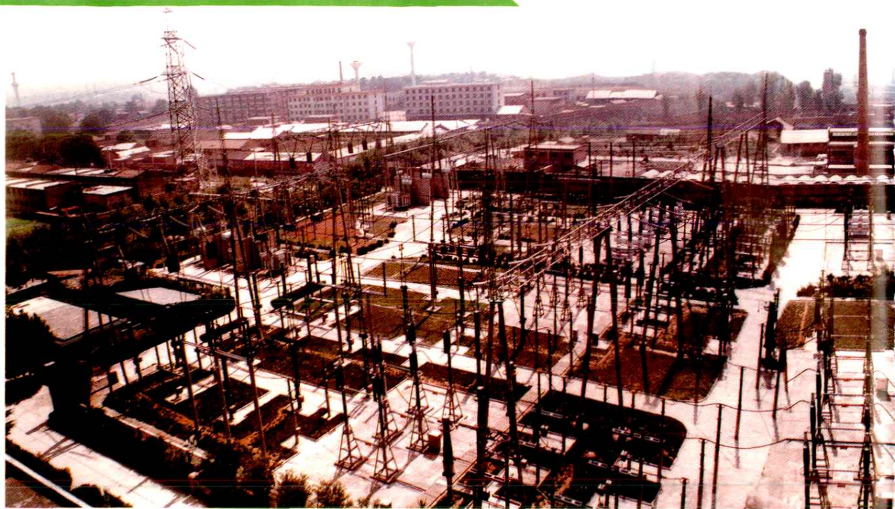
330 千伏西安南郊变电站
