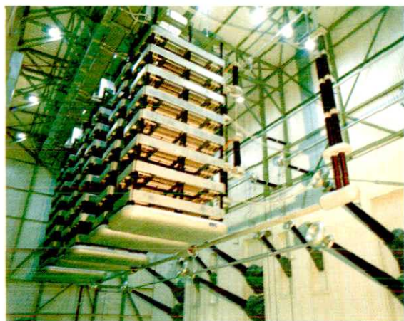
葛洲坝 500 千伏换流站阀厅
