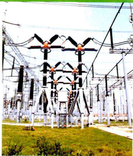
500 千伏姚孟升压站的一角，升压变压器 容量 147 万千伏·安，1981 年 12 月投运
