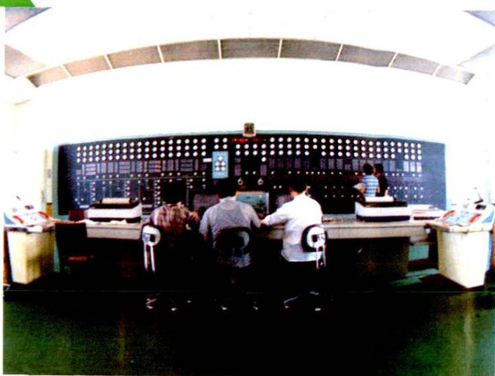
500 千伏株洲云田变电站主控制室， 变电站容量 75 万千伏·安，1988 年 6 月投运
