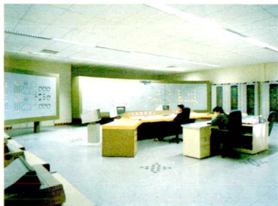
葛洲坝 500 千伏换流站主控制室
