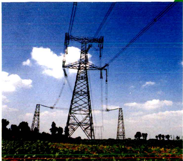
500 千伏平顶山—武昌输电线路终端换相塔
