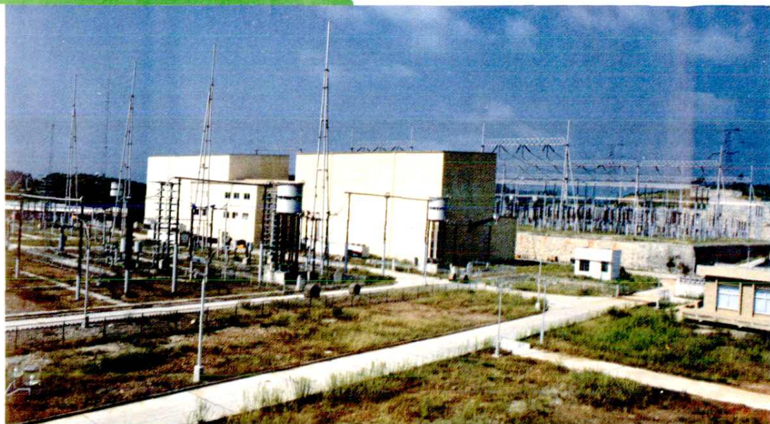
葛洲坝 500 千伏换流站，1989 年 9 月单极投运，1990 年 8 月双极投运
