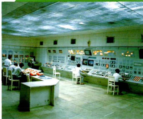
汉川电厂主控制室
