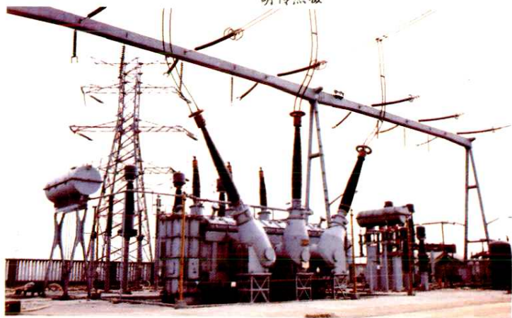
500 千伏葛洲坝升压站，联络变压器容量 36 万千伏·安，1986 年 6 月投运
