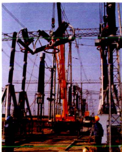
500 千伏武昌凤凰山变电站
