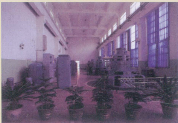
铁门关水电厂厂房
