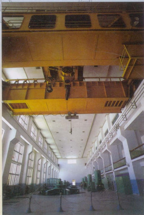
大山口水电厂厂房
