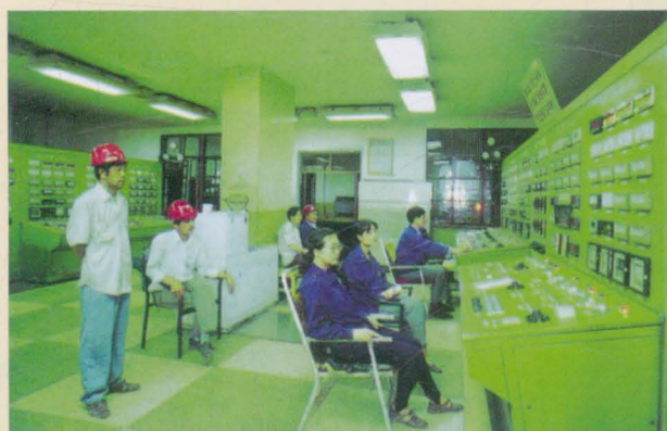
塔什店火电厂主控室
