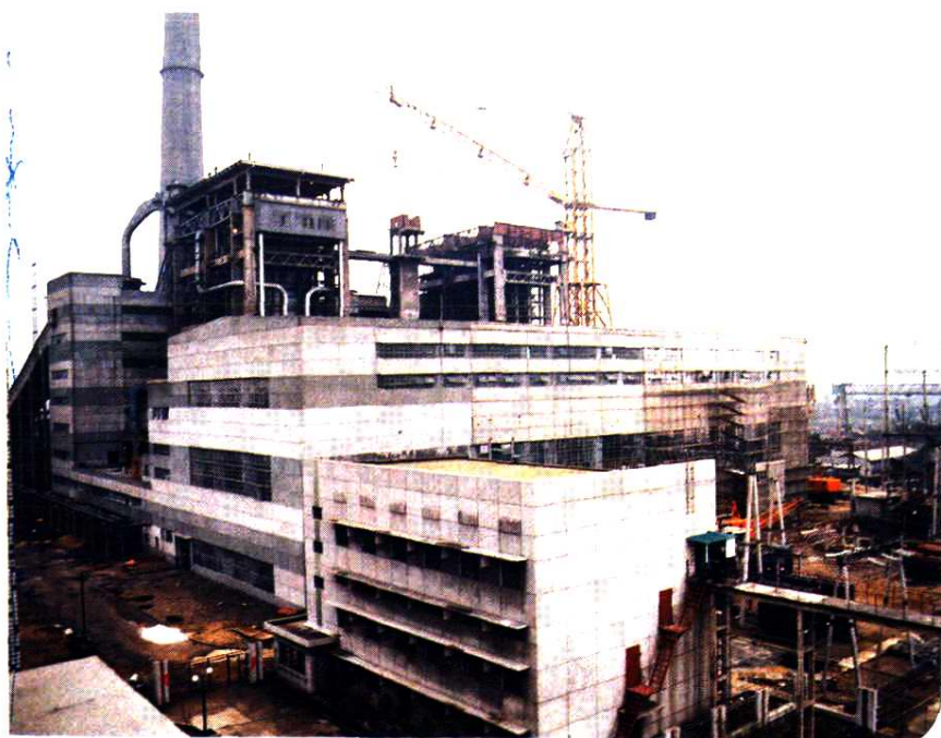
超高压机组主厂房
