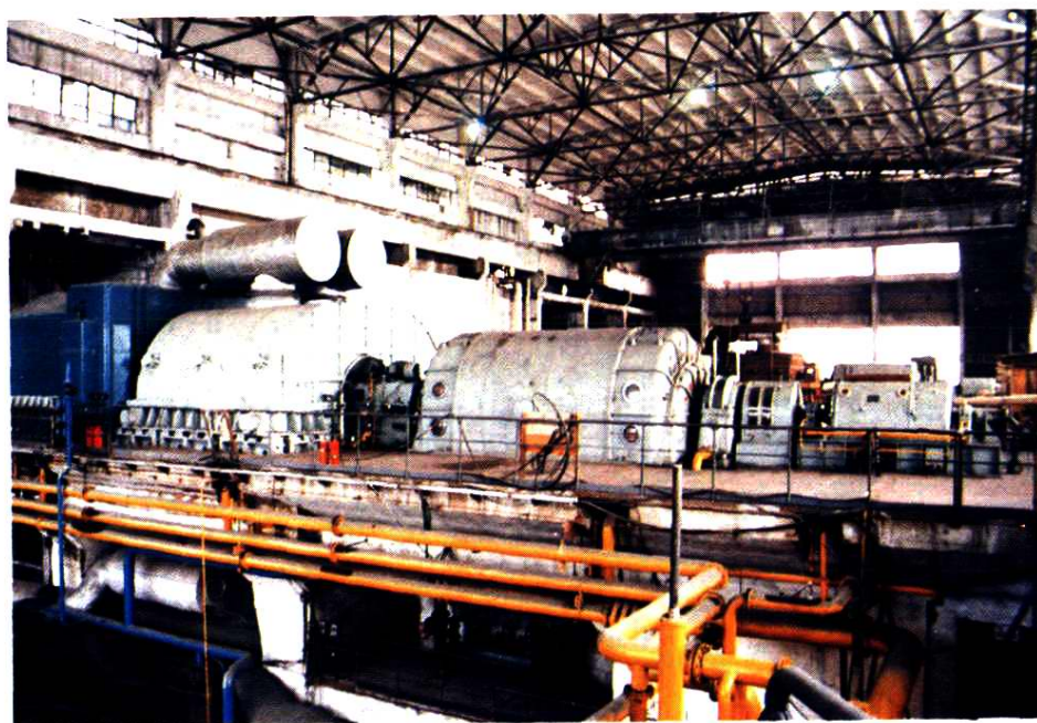
超高压机组机房
