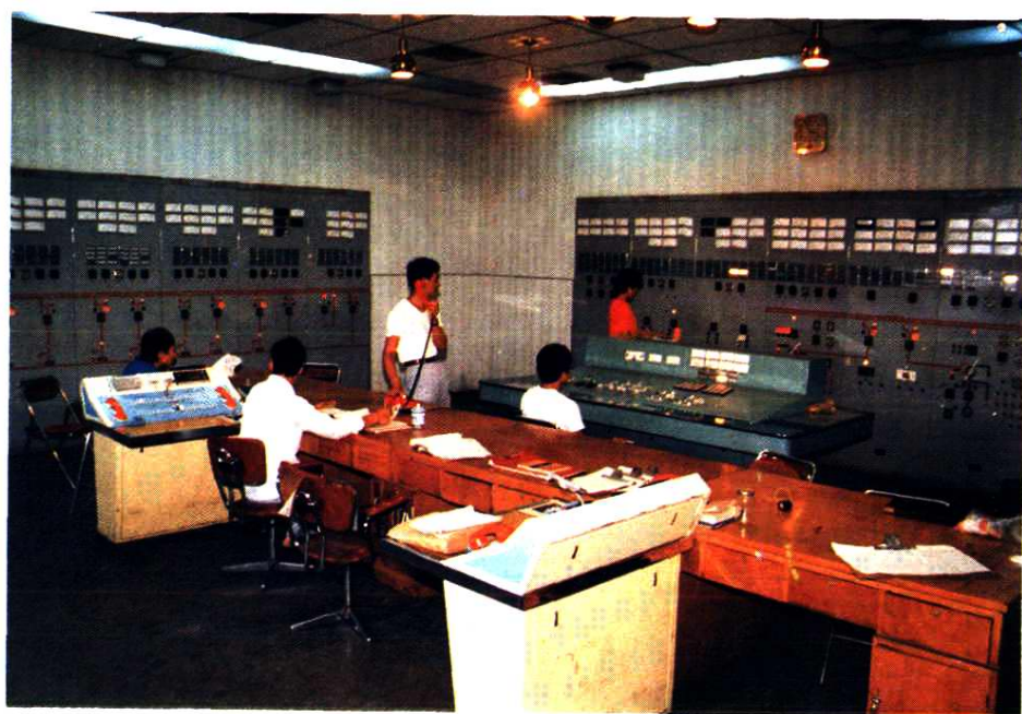
超高压机组主控室
