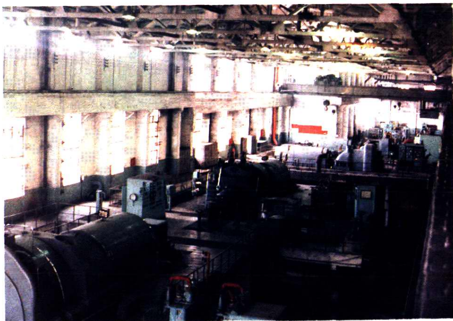
中压机组机房
