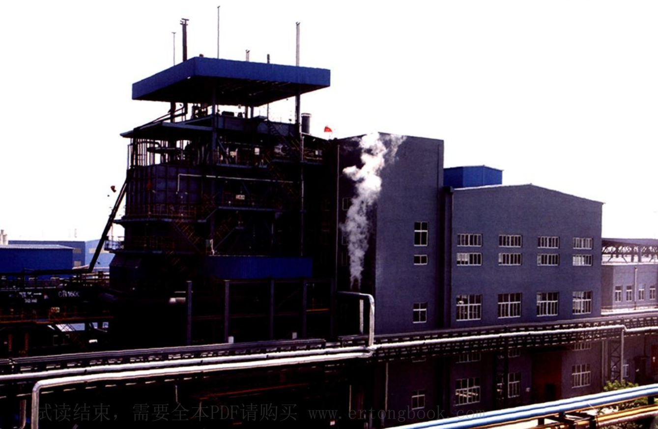
燃气锅炉发电
