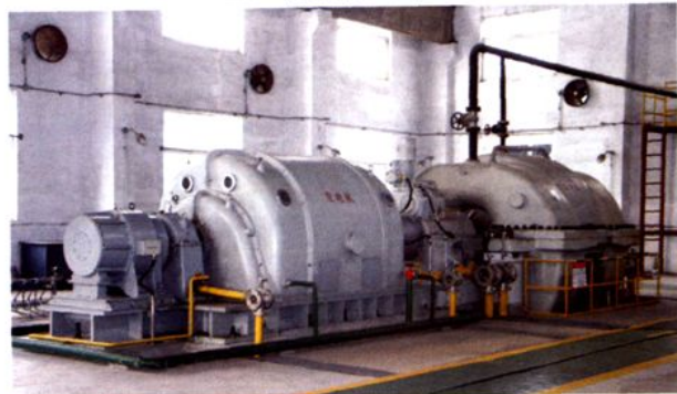
高炉煤气余压发电
