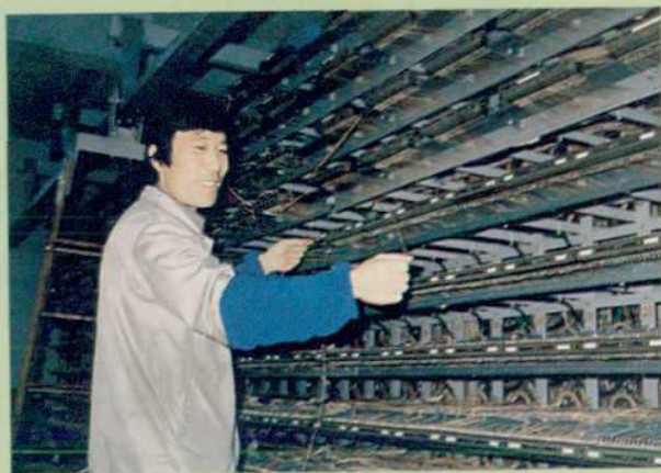
西方式202回线总配线架
