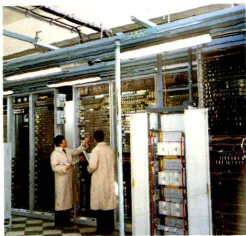
程控交换机房
