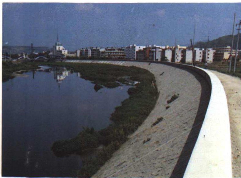
新昌江防洪堤
