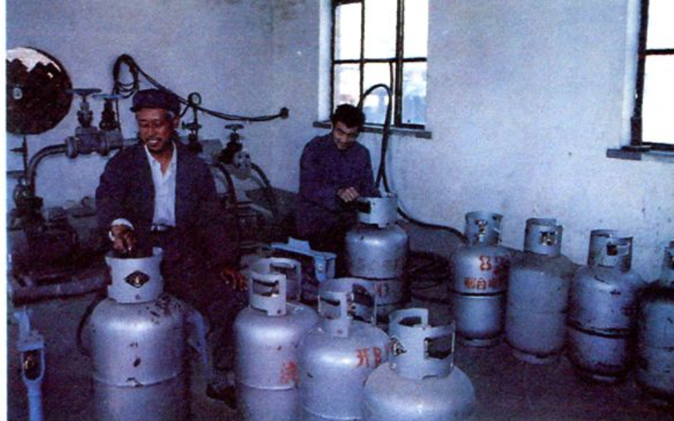
石油液化气站
