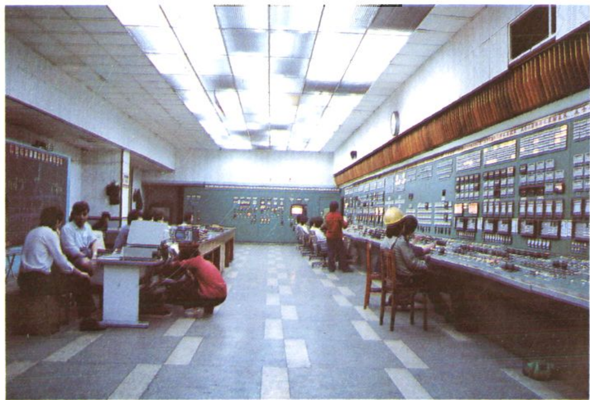
4、5 号发电机组主控制室
