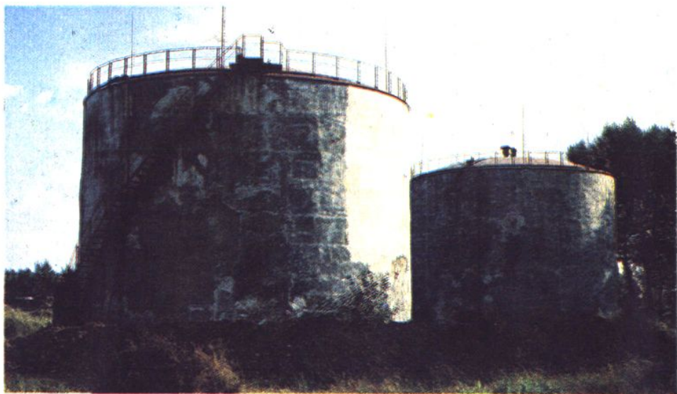
小南燃料供应站储油罐
