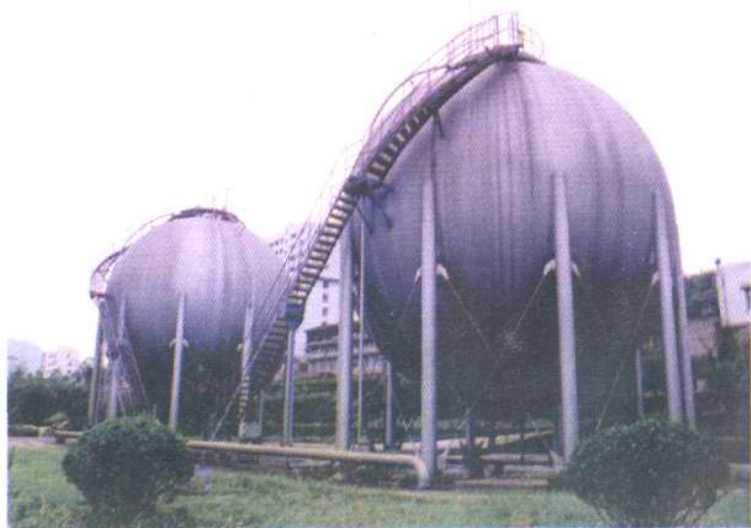
天然气储气站
