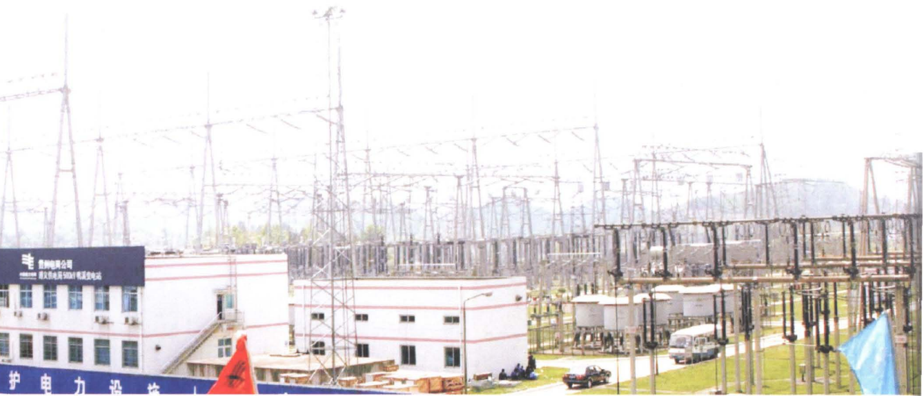
500千伏鸭溪变电站
