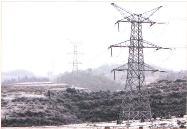
遵义电网线路
