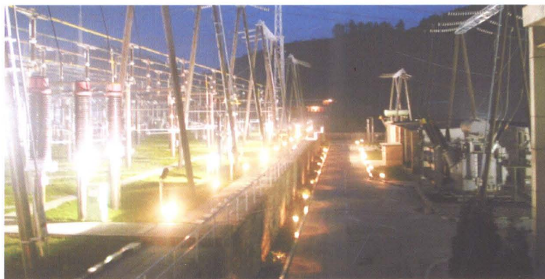
220千伏海龙变电站夜景
