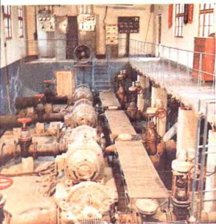
五里堡水源泵房
