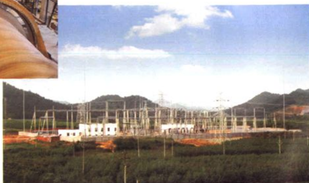
驻县电气化铁路变电站
