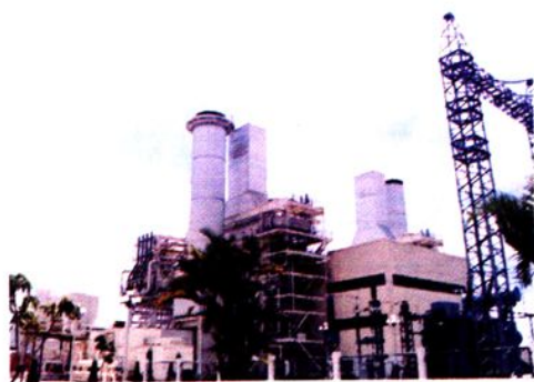
汕特燃机电厂 (10.50 万千瓦) 1994 年建成。
