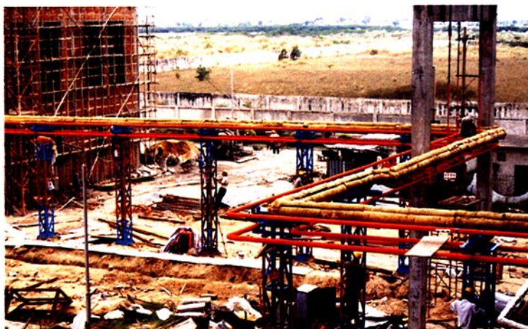
● 2000年万丰热电厂进行2号锅炉改燃水煤浆技改工程。
